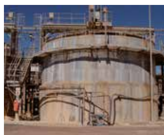
STRUTTURE IN AMBIENTI AGGRESSIVI
